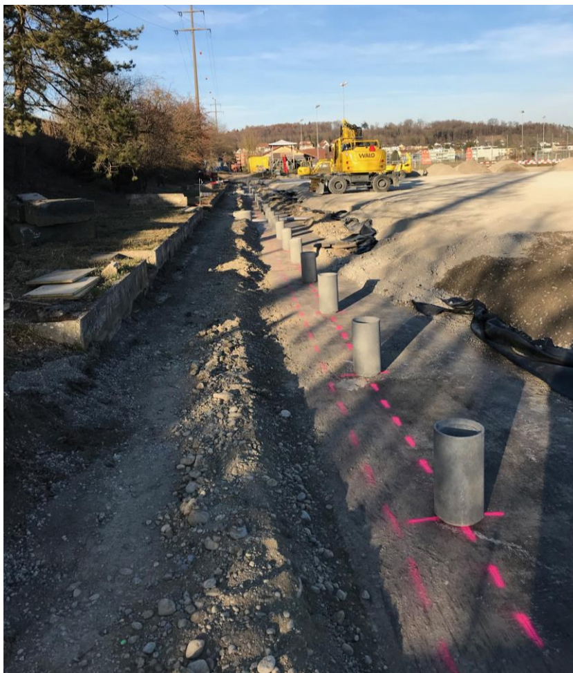
Zaunfundamente auf Mischwasserkanal
